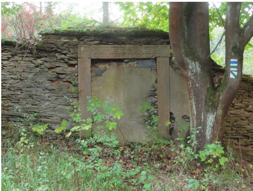
20. Rabštejn nad Střelou (okr. Plzeň-sever) – zadržný vstupní portál hřbitova z důvodu navýšení nivelety pohřebiště kvůli pohřbívání ve vrstvách. Foto autor, 2025.
